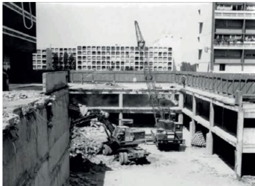
Destruction partielle de la dalle des Aubiers, 1982 © CANTAT-CORSINI
